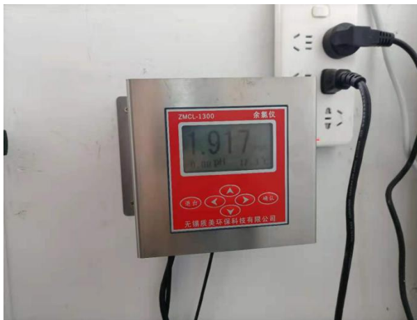
废水余氯在线监测系统
