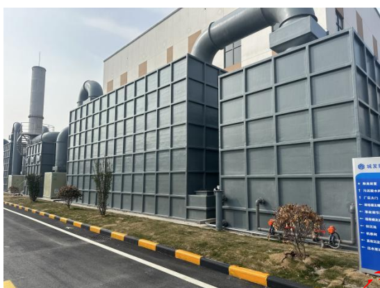
TA003装置（化学除臭+生物除臭+活性炭）
