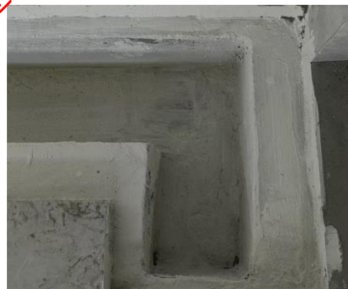
危废库收集池
