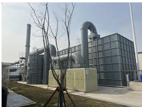
TA001装置（化学除臭+生物除臭+活性炭）
