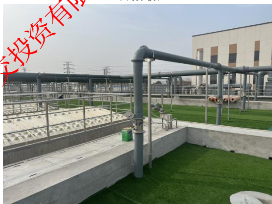
高效沉淀池及水解酸化池
