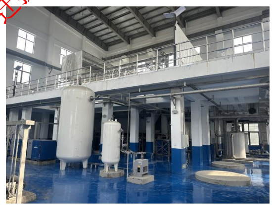
污泥浓缩脱水机房
